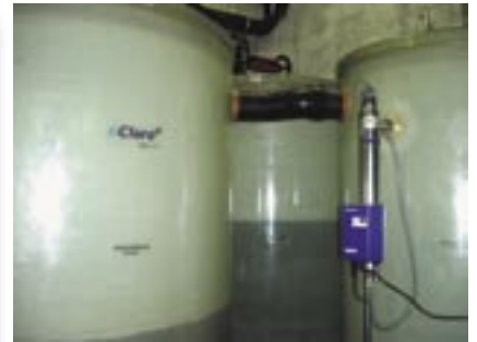
Die kompakte Anlage auf Hohtälli
